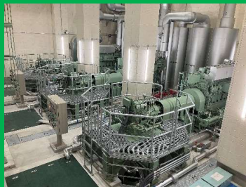
ポンプ原動機・減速機
