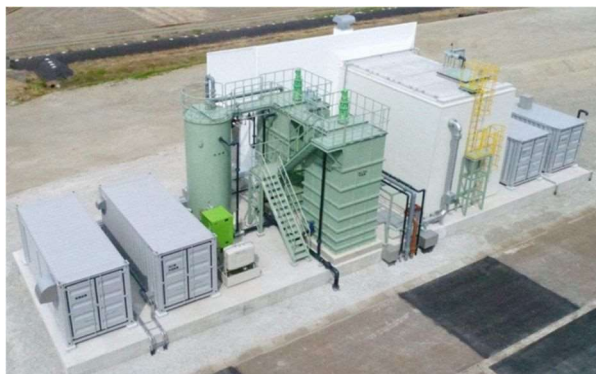
写真 高濃度メタン発酵処理装置
