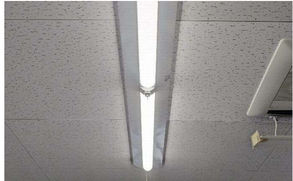
写真 執務室のLED照明
