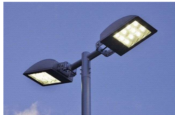
写真 LED 公衆街路灯
