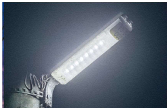
写真 LED 公衆街路灯
