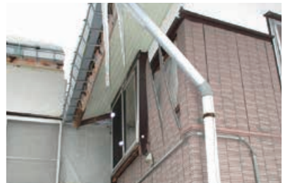
▲外壁の被害があった家屋。撮影の際は、転落などの事故に注意してください
