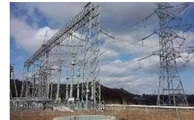
新福島変電所
