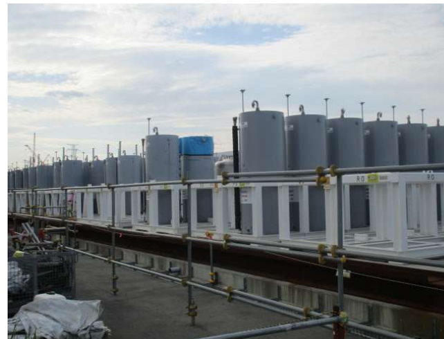
汚染水処理後の保管タンク群
