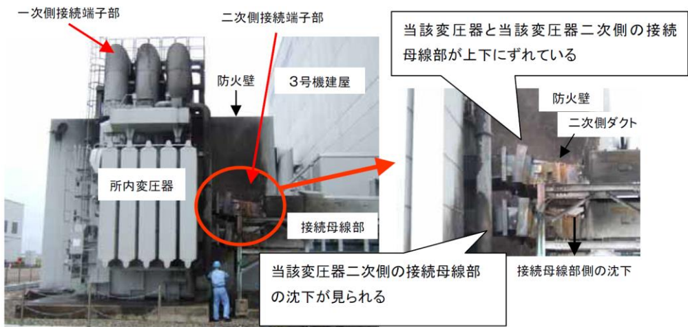
外観／二次側接続母線部損傷状況(冷却器側)
