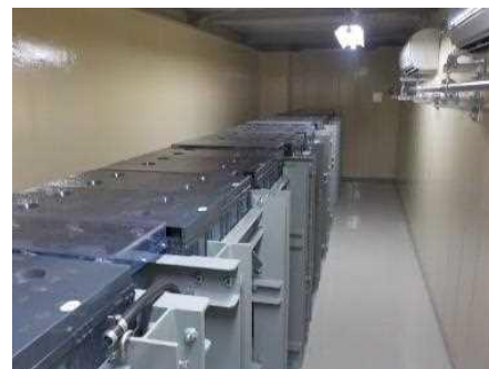
直流12V蓄電池
