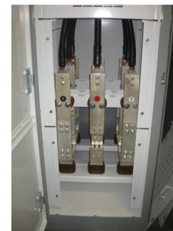
緊急用切替箱接続装置
