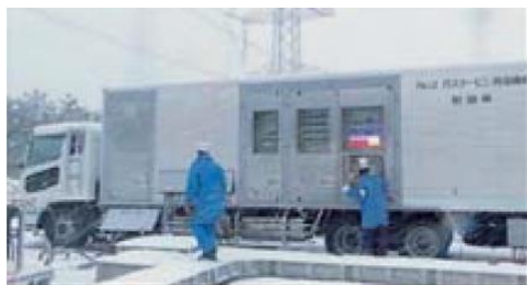
常設代替交流電源設備 (設置場所に固定し常設化)
