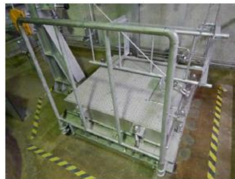
※ 浸水防止設備の例(取水槽閉止板)
