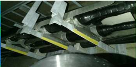
<66kV GIS～LSTr6SB間の接続部>
