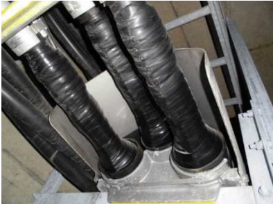
<66kV GIS～LSTr6SB間の接続部>
