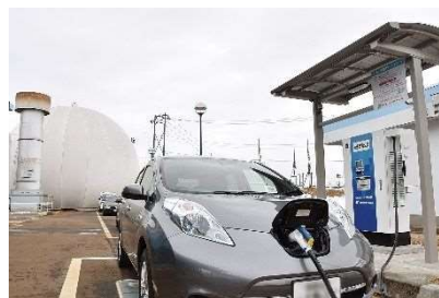
発電した電気を活用した 電気自動車用急速充電器
