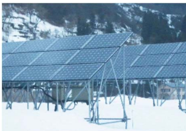
写真 寒冷地における太陽光発電の工夫 (栃尾地域)
