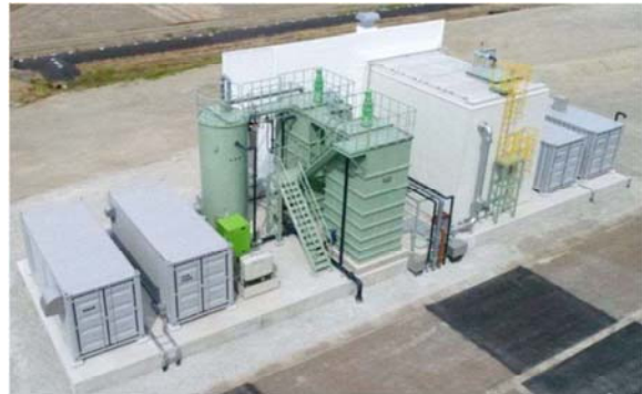
写真 高濃度メタン発酵処理装置
