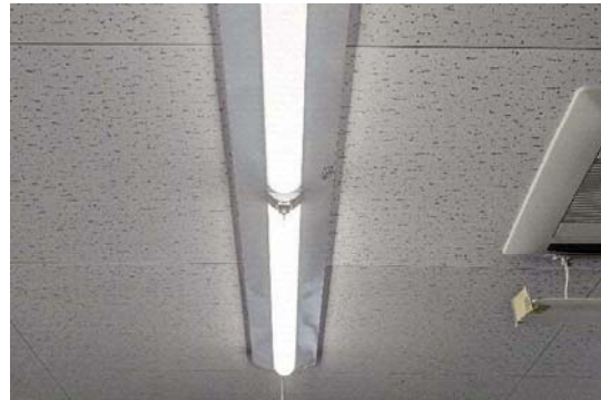
写真 執務室のLED照明
