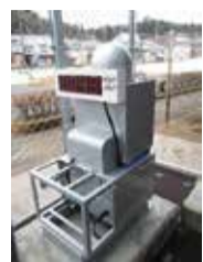
栃尾支所に設置されたモニタリングポスト
