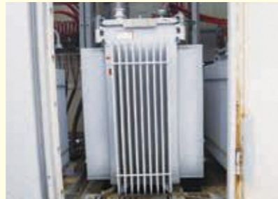
トランス(変圧器)
