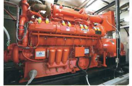
ガスエンジン発電機
