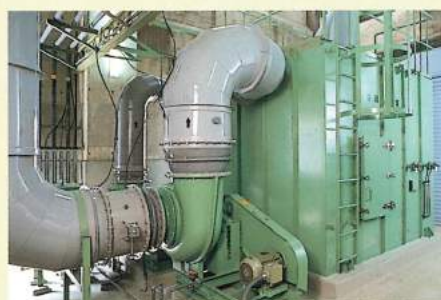
活性炭吸着塔
