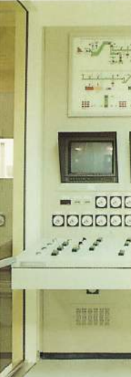
●中央監視盤・中施設内の各機器の稼働を監視します。
