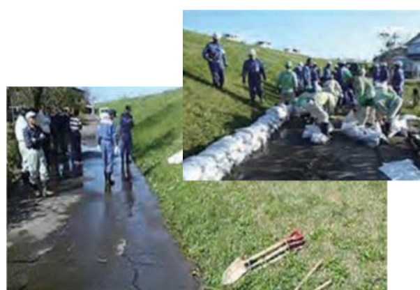
令和元年台風第19号による堤防の漏水(長岡地域)
