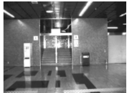
新幹線改札内のトイレ 車いす対応トイレが設置されていない。
