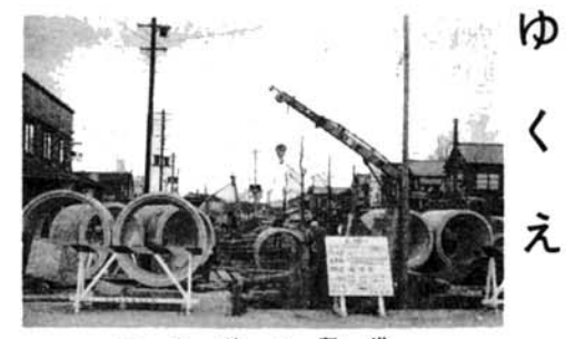
下水道の整備
