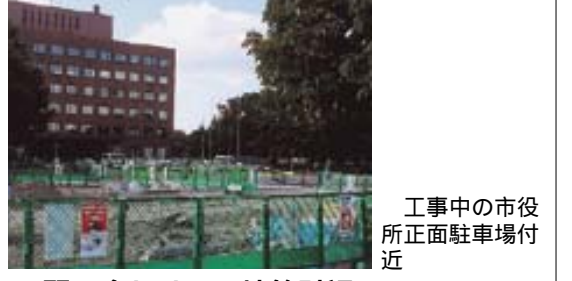
工事中の市役所正面駐車場付近 問い合わせ = 用地管財課 ☎ 39・2211
