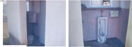
便器の老朽化
