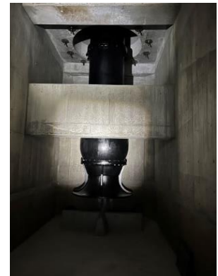
▲水路階のポンプ設備
