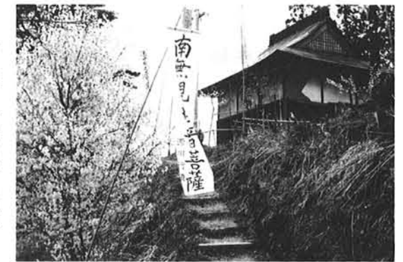
▶壁も落ち、修理前の観音堂
