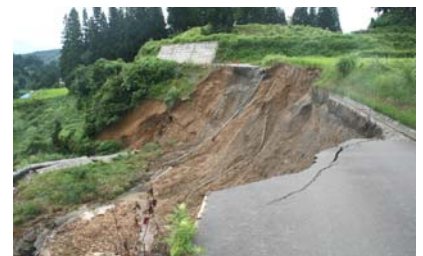
市道（種苧原）が40mにわたって崩落
