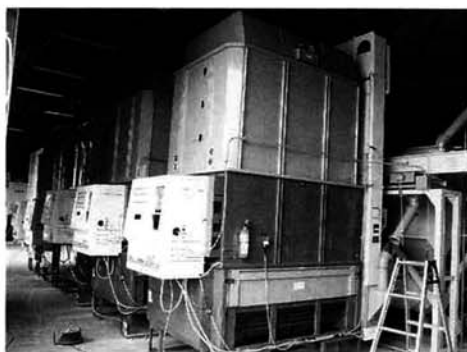
大型の乾燥機が設置されています
