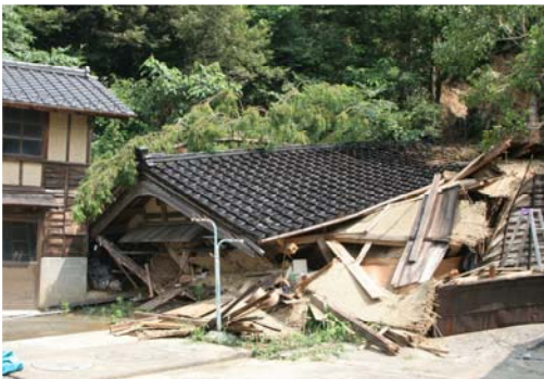
▲全壊した作業小屋(中小島谷)
