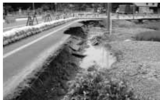
県道高梅田線路肩法面崩壊 7月18日
