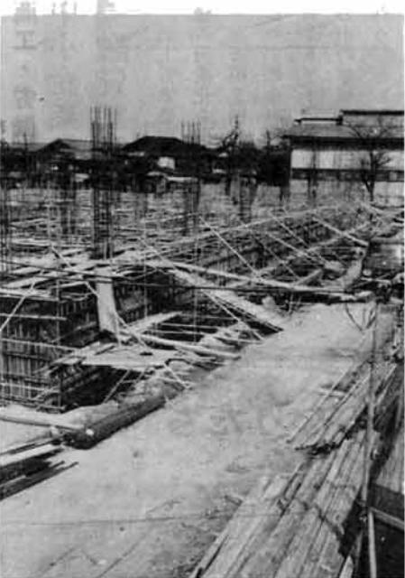
市民会館は、2億6734万円をかけ今年度完成をめざして建設が進められています（4月6日撮影）
