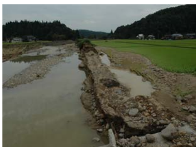
▲決壊した塩谷川の堤防(沖布地内)
