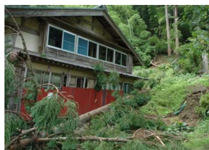
▲裏山が崩れ住宅に押し寄せた(九川地内)
