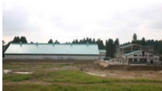
来年3月の供用開始に向け、着々と工事が進む最終処分場(文納地内)
