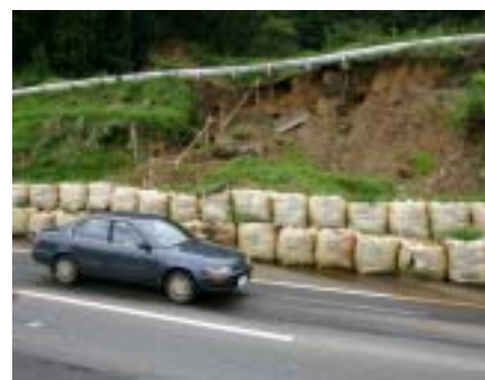
本復旧が必要な国道351号 (大野地内)
