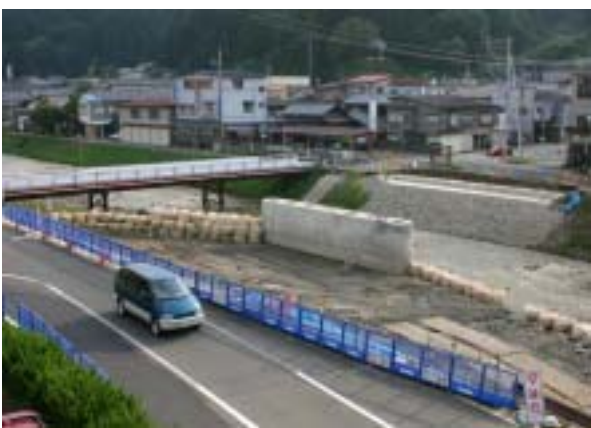
十月から橋桁架設が始まる新金橋架替工事。来年三月末の完成を目標として、工事を進めています。
