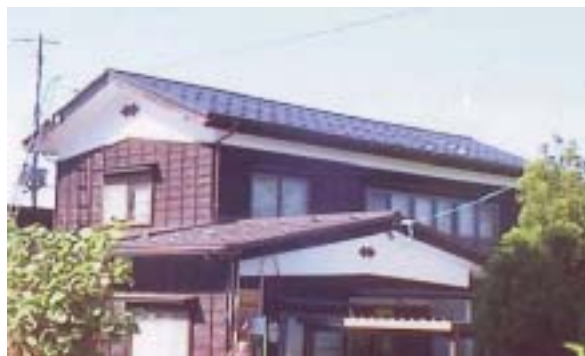
栃尾市克雪住宅整備事業補助金の交付を受けて整備されたソーラーシステムによる融雪屋根。雪下ろしから開放され、節電にも効果を発揮
