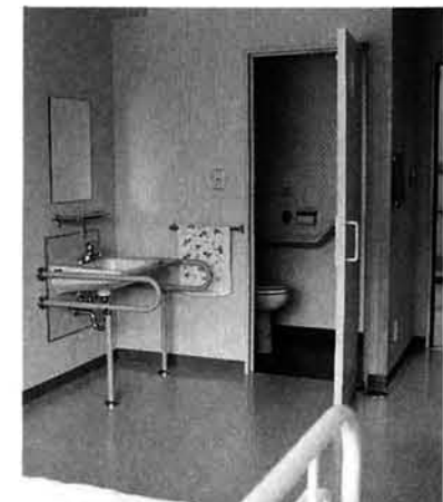
▲痴呆室 部屋にはトイレ、監視装置が設置されています。
