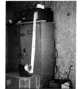
▲設置された地震計
