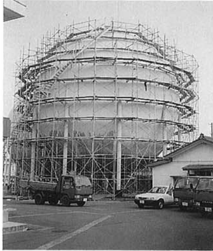
ガスホルダーの漏洩検査
