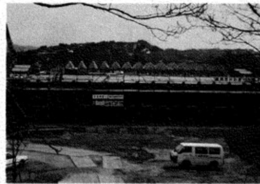
▶急ピッチで工事が進む屋内ゲートボール場「すばく川口」
